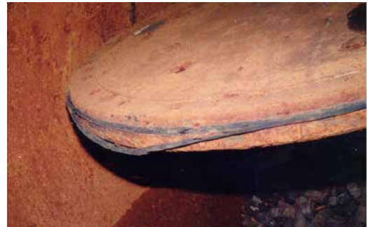
EXZENTERKLAPPE DN800, PN10: 12 Jahre im Netz, der für Exzenterklappen typische, schmale Dichtring ist defekt.
